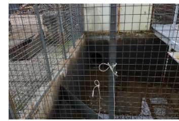
Fosse Eaux Pluviales
